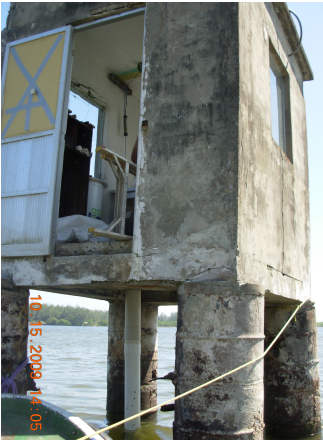
TUXPAN, VER. CASETA MAREOGRAFICA QUE REQUIERE RECONSTRUCCION
